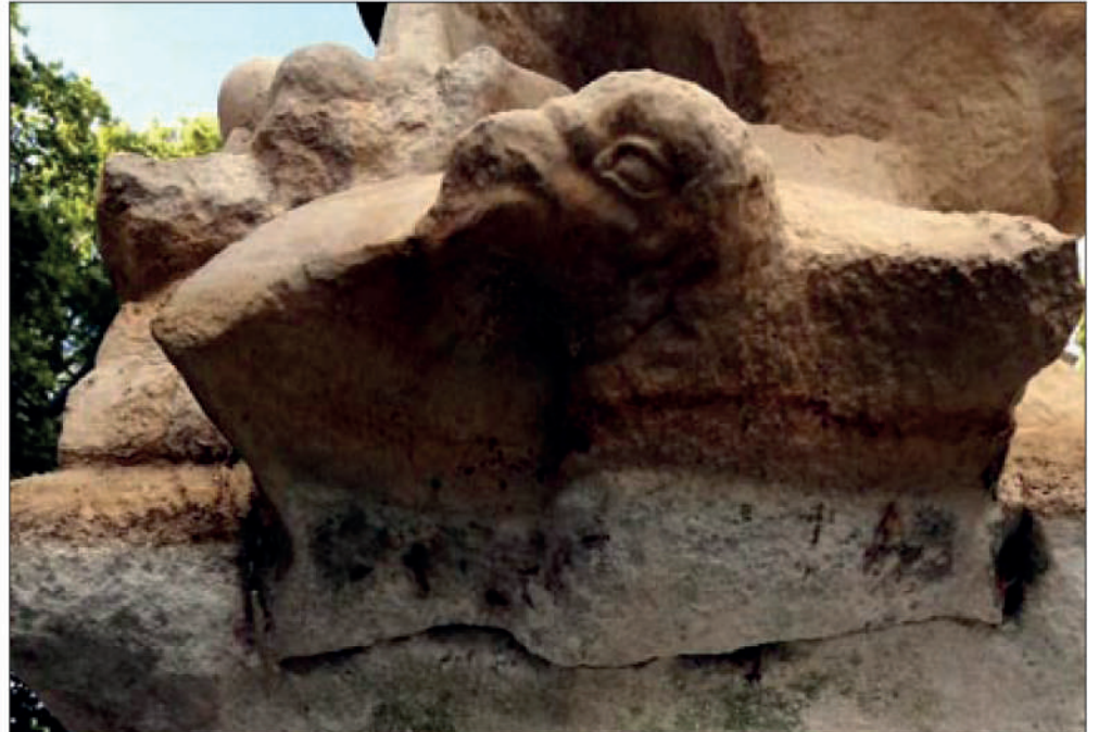
Estado previo del pedestal
