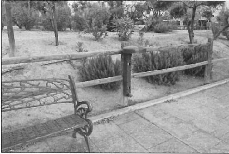
Estado de la valla del circuito MTB
